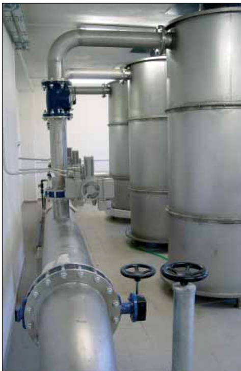
• Úpravna vody Krnov Zlatá Opavice, aerace
