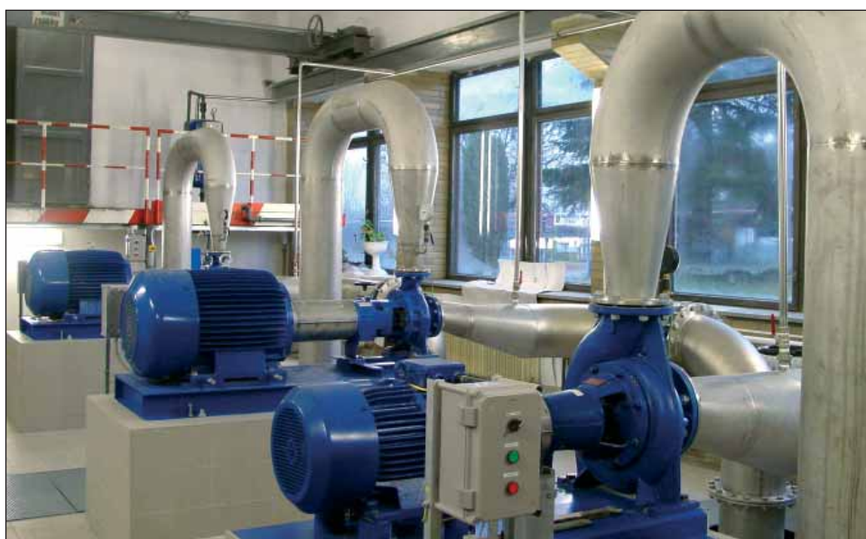
• Úpravna vody Krnov Zlatá Opavice, strojovna
